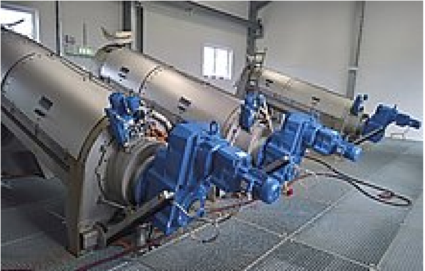
Drei HUBER Schneckenpressen Q-PRESS® (zwei zur Entwässerung von Überschussschlamm und eine zur Entwässerung von Flotatschlamm)
