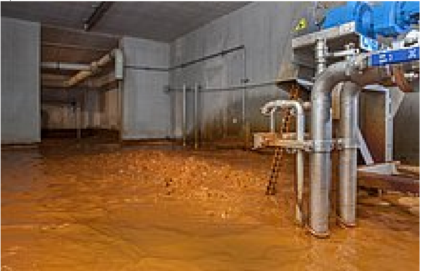
Bild 4: Membranbiologie, eine Filtrationskammer mit HUBER Membranfiltration VRM® 30/18 RF
