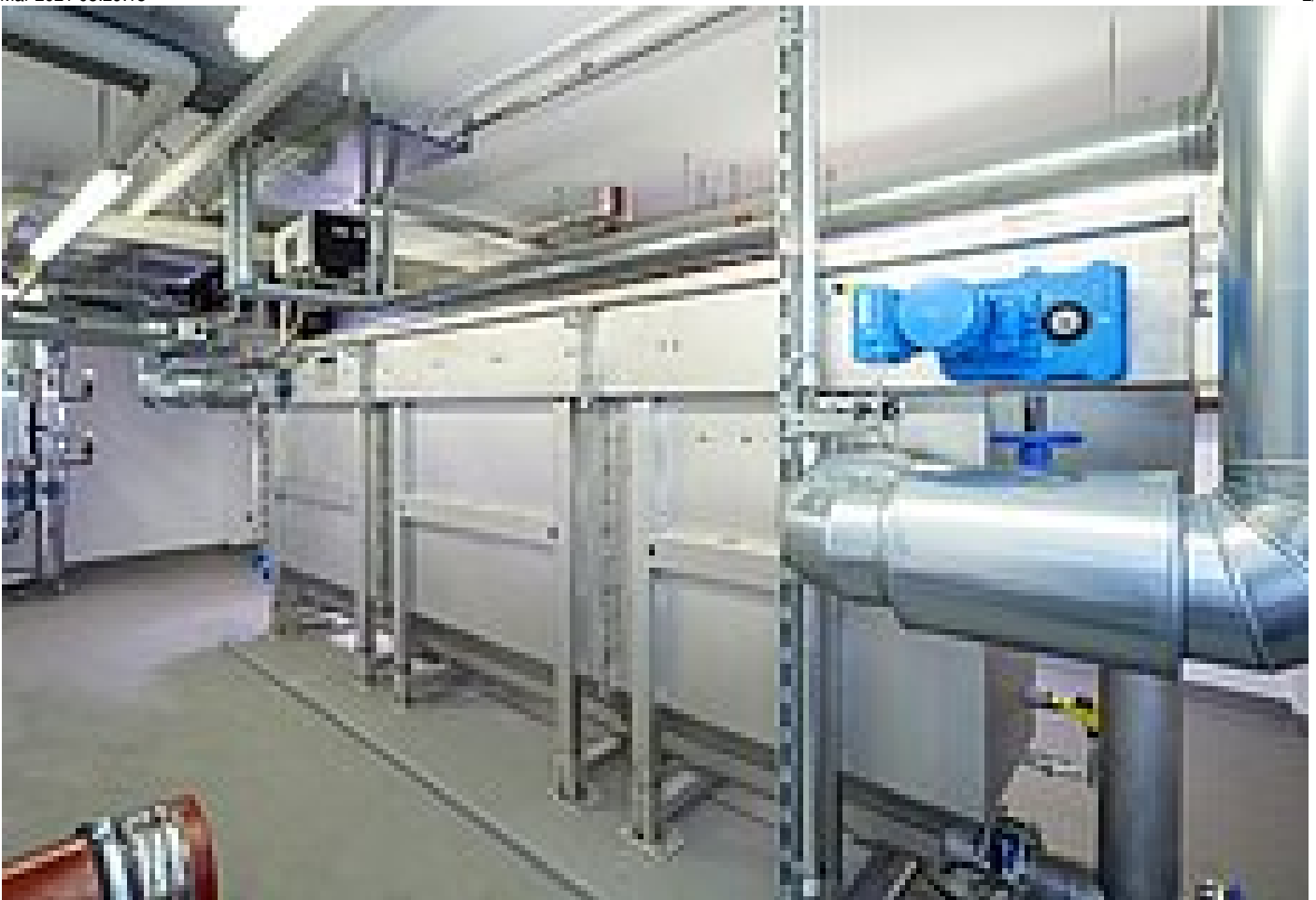
Geflanschte Version des HUBER Wärmetauschers RoWin - perfekt eingebracht und installiert auch bei beengten Platzverhältnissen
