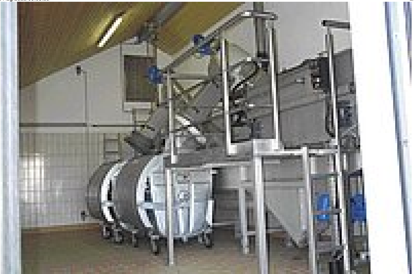
HUBER Kompaktanlage vom Typ Ro 5 mit Siebanlage Ro 2 600/2 mm
