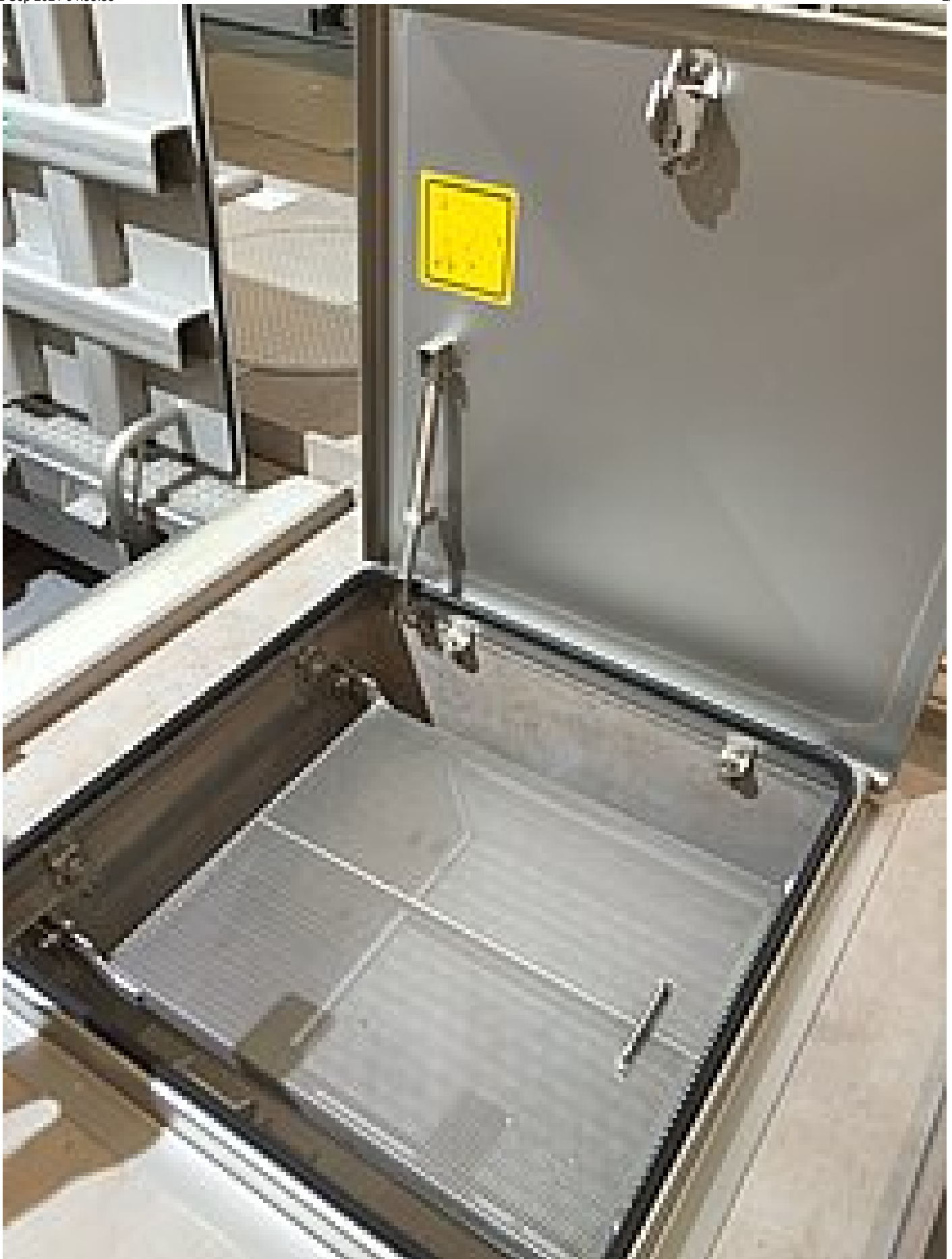
Schachtabdeckung mit geschlossenem Absturzgitter
