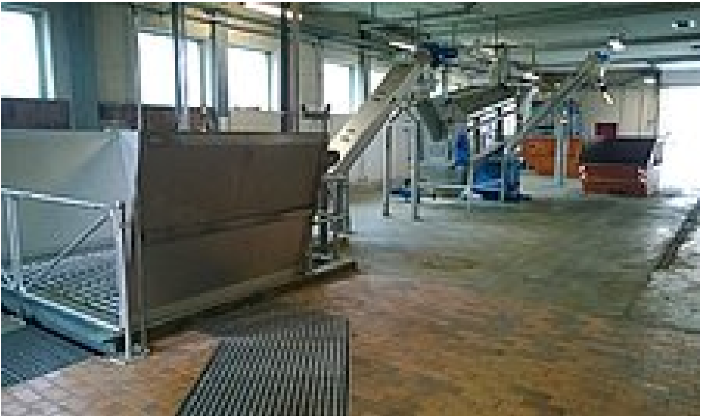
Sandannahmeverfahren RoSF5 VW an der Kläranlage Koblenz
