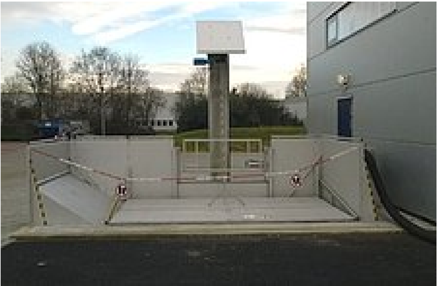
Sandannahmeverfahren RoSF5 HW mit automatischer Abdeckung des Annahmebunkers an der Kläranlage Frankfurt Niederrad
