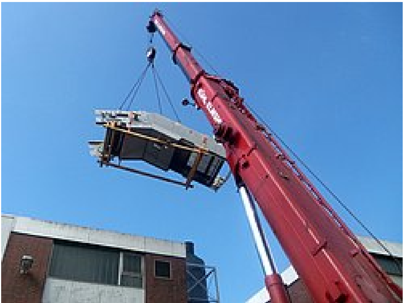
Mit einem Spezialkran wurde der 3,5 Tonnen schwere Koloss an seinen Standort gehievt
