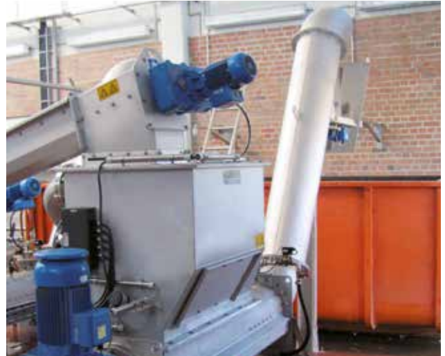
HUBER Trogförderschnecke Ro8 T wirft Rechengut in eine HUBER Waschpresse WAP® SL.
