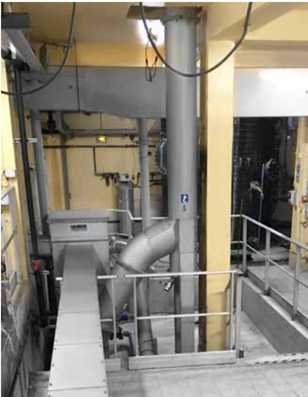
Unterirdische Rechengutanlage, vertikaler Waschpressenaustrag mit nachgeschalteter Ro8 V.
