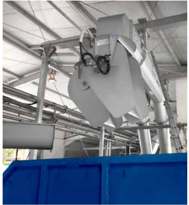
Offene Verteilerrutsche für Rechengut im Tip-Betrieb.
