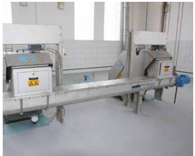
Förderung von Rechengut mit zwei parallel einwerfenden Rechen.
