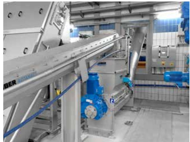
Förderlösung in der mechanischen Vorreinigung für ungespresstes Rechengut.
