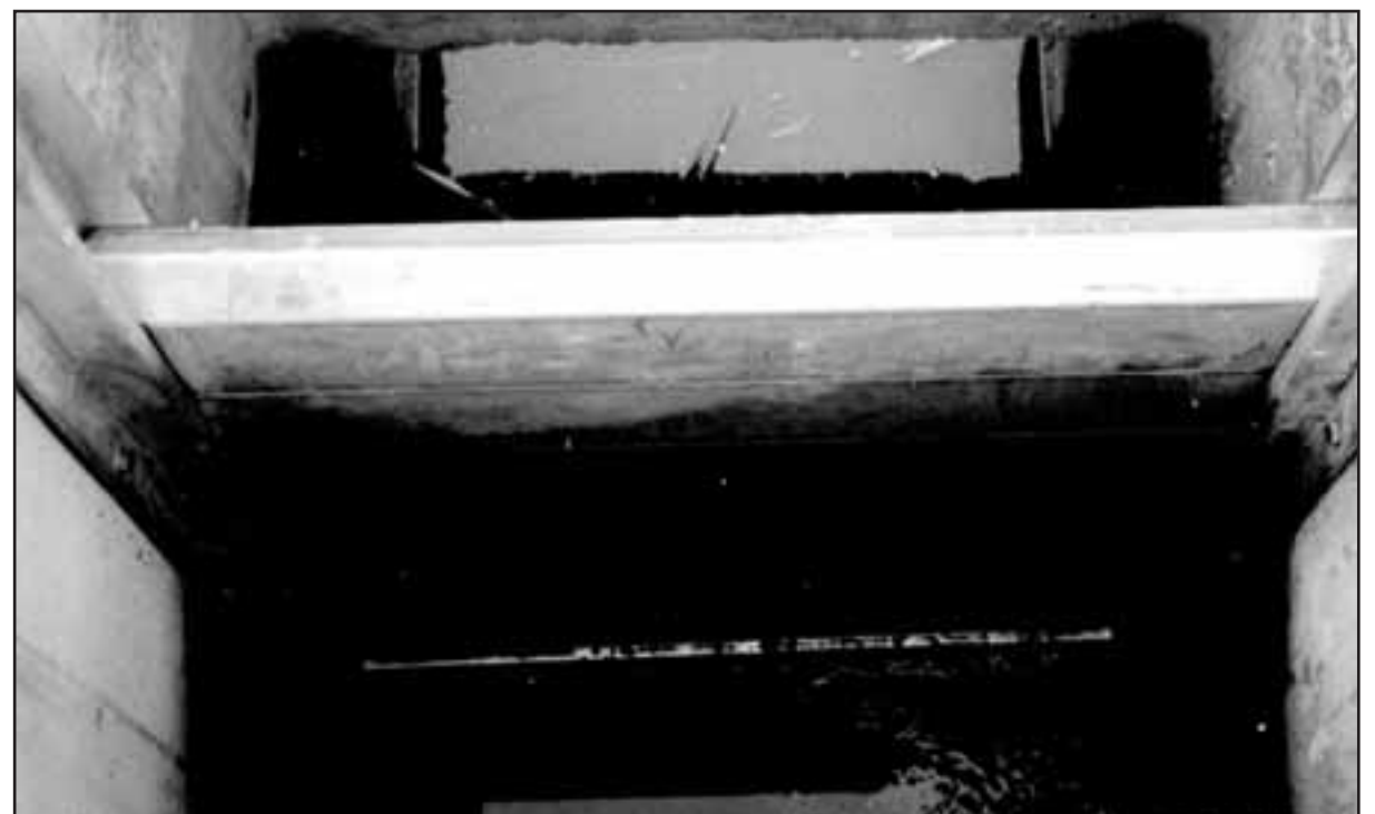
Edelstahldammbalken in einem Ablaufmönch einer Abwasserteichanlage
