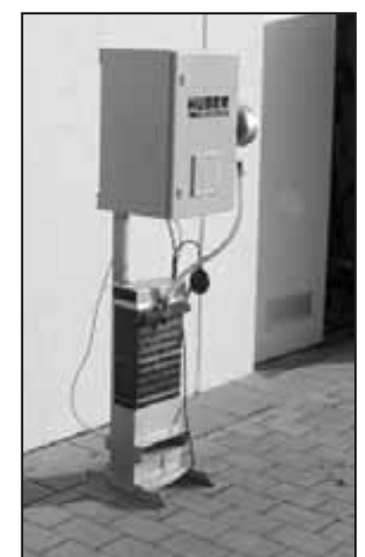
Bild 4: VUM-Anlage (frei aufgestellt)
