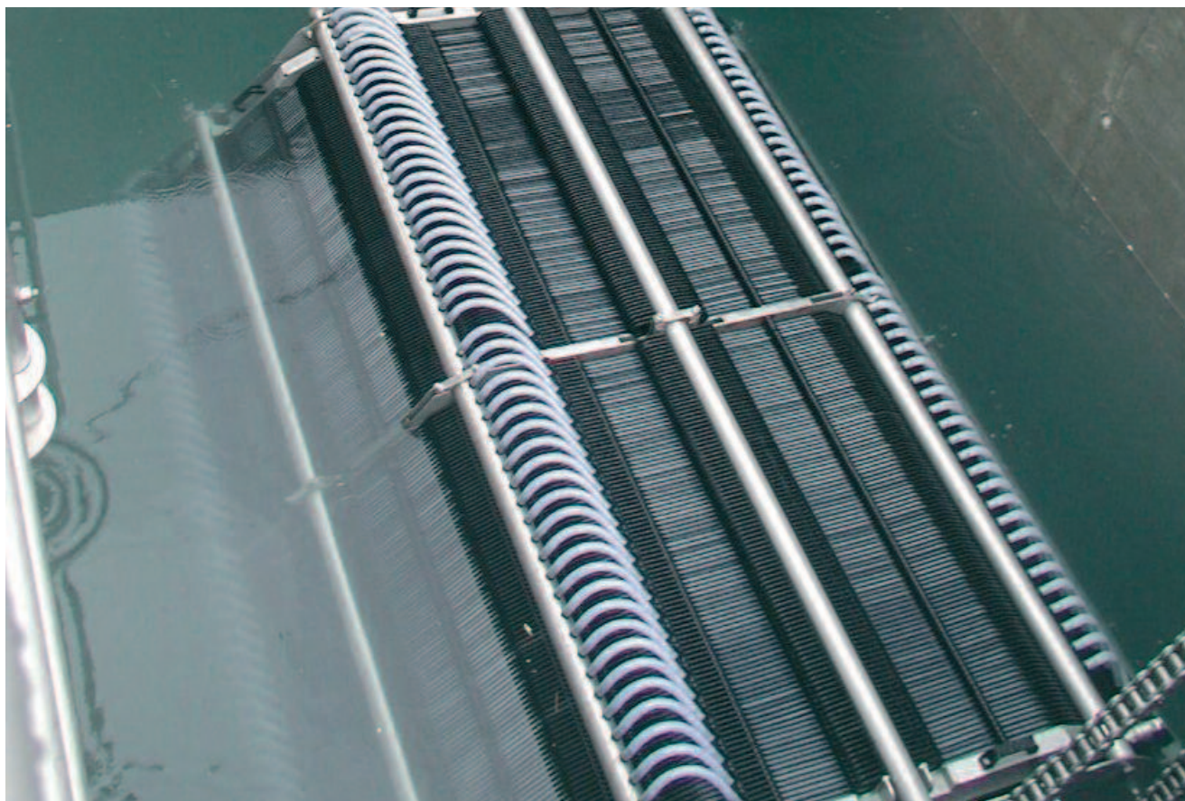
Membranfiltrationskammer vor der Inbetriebnahme
