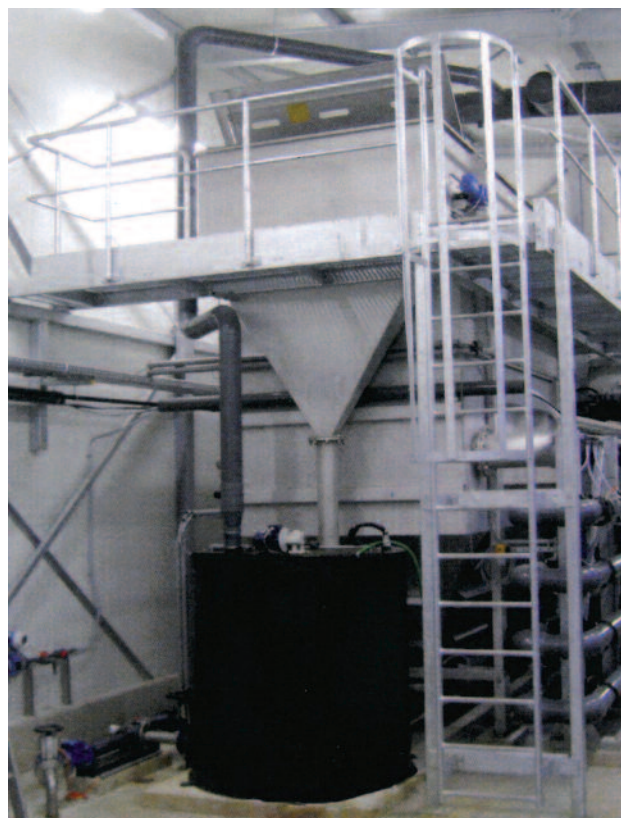
HUBER Druckentspannungsflotation HDF 10 während der Inbetriebnahme
