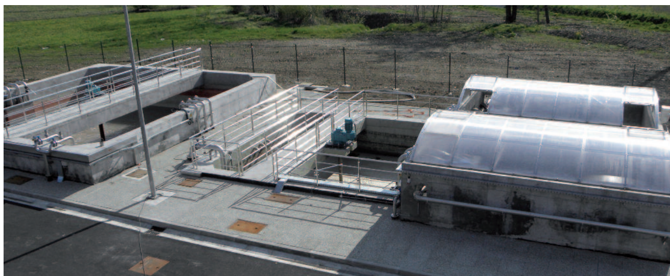
Misch- und Ausgleichsbecken, Biologiebecken und HUBER Membranbiologie
