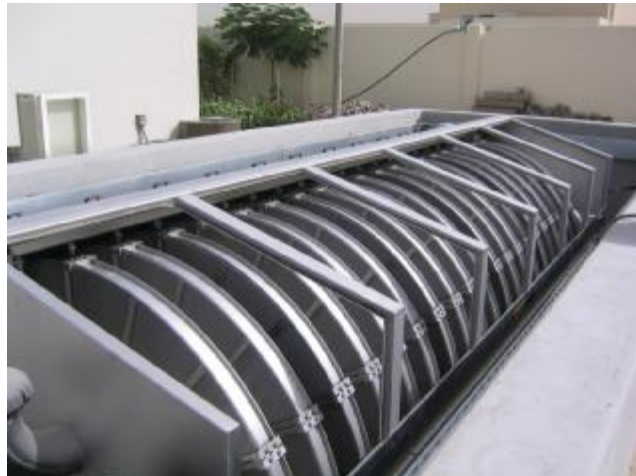
Ein installierter Scheibenfilter RoDisc®
