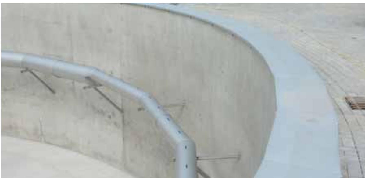
Beckenkronenabdeckung schützt die Laufbahn des Räumers
