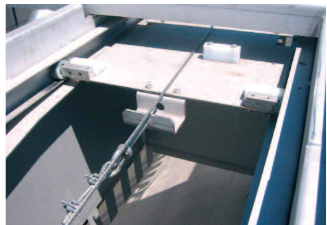
Teilautomatische Fetträumung mittels Fettpaddel
