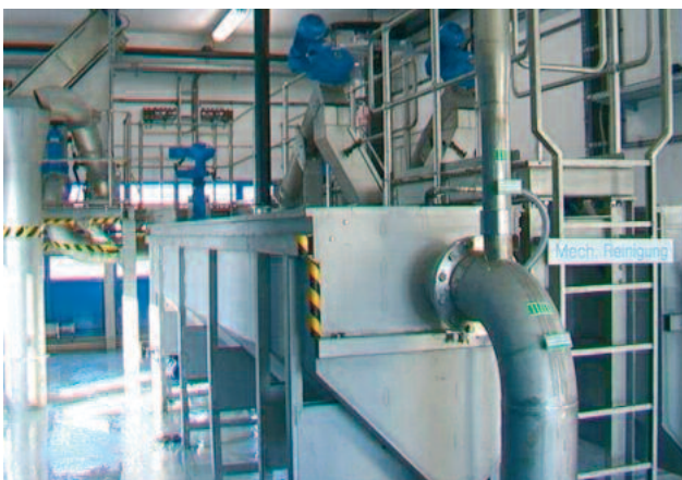
Oberirdische, redundante HUBER Sandfanganlage Ro 6
