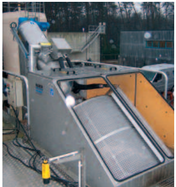
Freiluftaufstellung zur Abscheidung von Haaren und Faserstoffen vor einer Hohlfasermembrananlage
