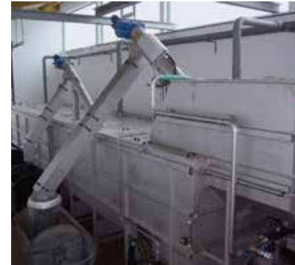
Komplette mechanische Abwasserbehandlung in einer Anlage.
