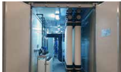
Vorreinigungsstufe mit Ultrafiltration zur Entfernung von Schwebstoffen.
