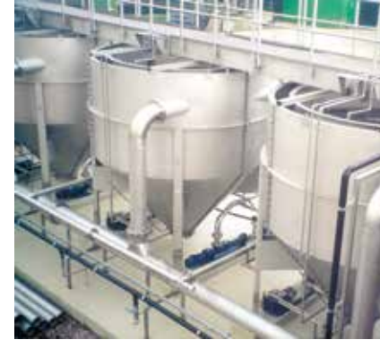
HUBER Rundsandfang HRSF im Betrieb.
