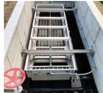
HUBER Abwasserwärmetauscher RoWin C eingebaut in Betongerinne.
