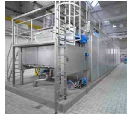
HUBER Bandrockner BT zur Klärschlamm-trocknung bis > 90 % TR.
