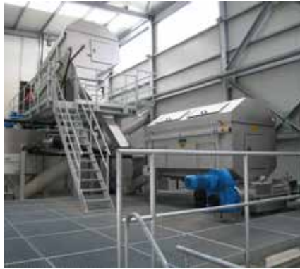
Komplett-Aufbereitungsverfahren für Kanalsande und Straßenkehricht.
