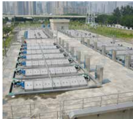
24 installierte HUBER Scheibenfilter RoDisc®.
