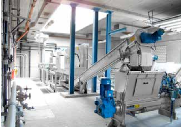
Drei HUBER Stufenrechen STEP SCREEN® SSV: Länge 4300, Breite 1176, Spaltweite 3 mm. Eine optimale Anpassung an bauliche Gegebenheiten (große Abwurfhöhen, tiefe Gerinne) durch steilen Aufstellwinkel zwischen 70–80°.
