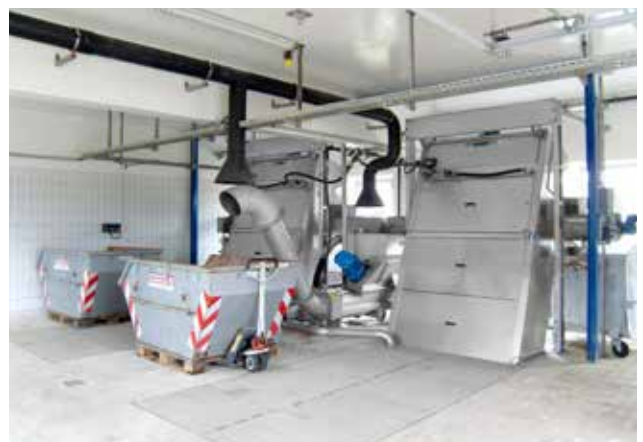
Zwei HUBER Stufenrechen STEP SCREEN® SSV, Länge 4300, Breite 1676, Spaltweite 6 mm, in Kombination mit der HUBER Rechengutwaschpresse WAP® der Baureihe SL für eine intensive Rechengutauswaschung in komplett geruchsgekapselter Ausführung.
