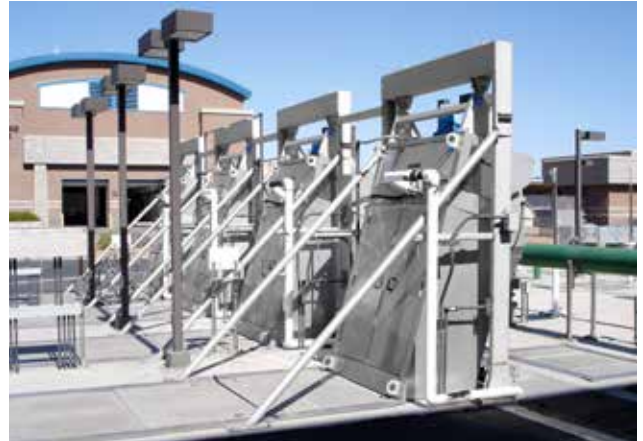
Vier HUBER Stufenrechen STEP SCREEN® SSV: Länge 5300, Breite 1376, Spaltweite 6 mm, Aufstellwinkel 75°. Höchste Betriebsstabilität durch speziell ausgebildete Bodenstufe zur Steigerung der Unempfindlichkeit gegenüber Sand, Splitt und Steinen.
