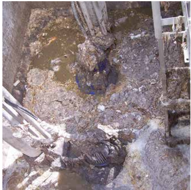
„Verstopfte Förderpumpen durch Feststoffe im zu fördernden Medium.“
