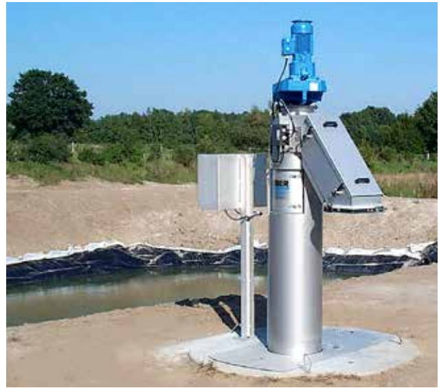
Einsatz im Zulauf vor einer Teichkläranlage.
