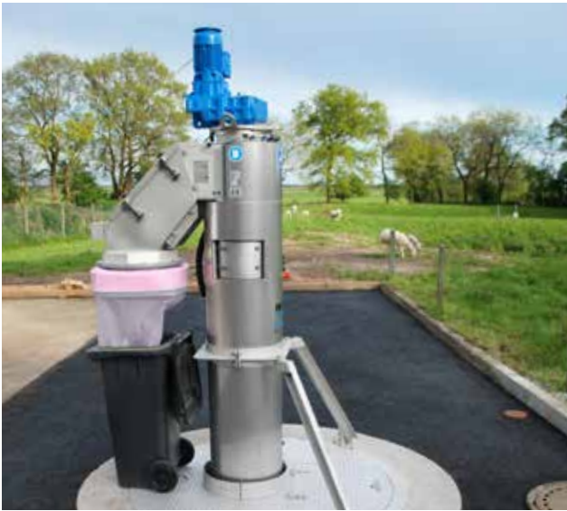
Beheizbare Außenaufstellung mit Endlosabsackvorrichtung für die Siebgutentsorgung.
