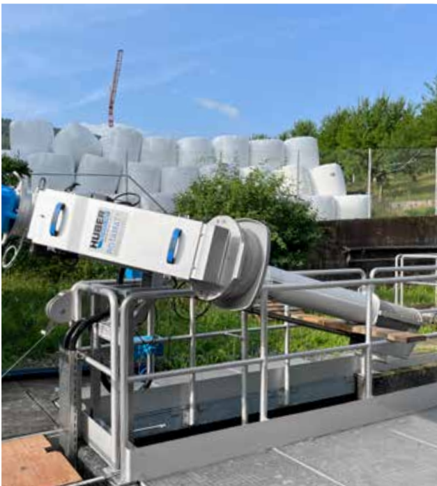
„Schnellausschwenksystem“ mit Seilzug für einfachen Wartungszugang außerhalb einer Gerinneinbausituation.
