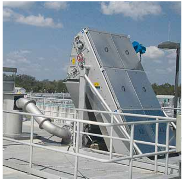
HUBER Lochblech-Umlaufrechen EscaMax® in geruchsgekapselter Ausführung mit leicht abnehmbaren Abdeckungen.
